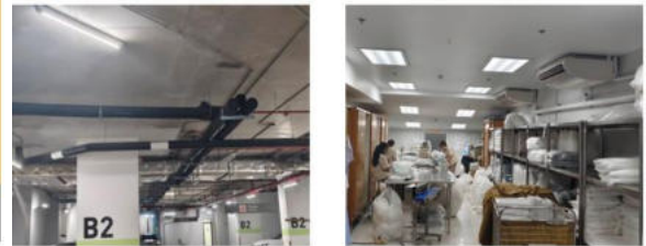
ระบบใหม่ท่อน้ำเย็น
